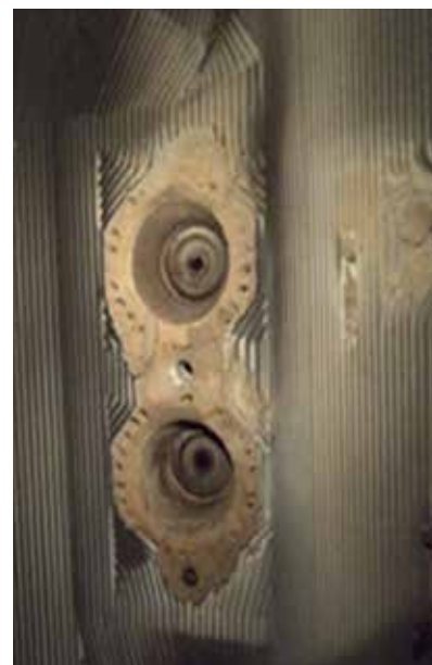
D) Widok palników w komorze spalania kotła pyłowego spalającego biomasę leśną i agro – na palniku i na ścianach komory brak jest spieków
